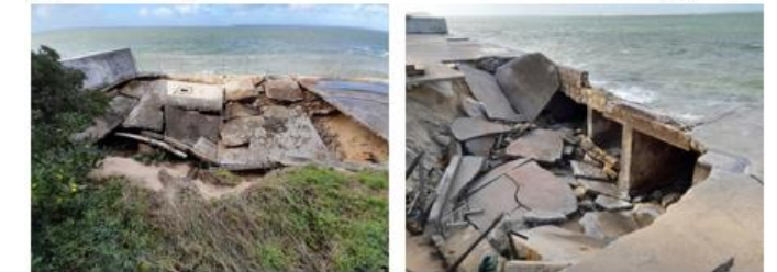
Figure 36 - Etat de certains ouvrages de protection du Pyla-sur-Mer le 29/10/2023. © CEREMA
