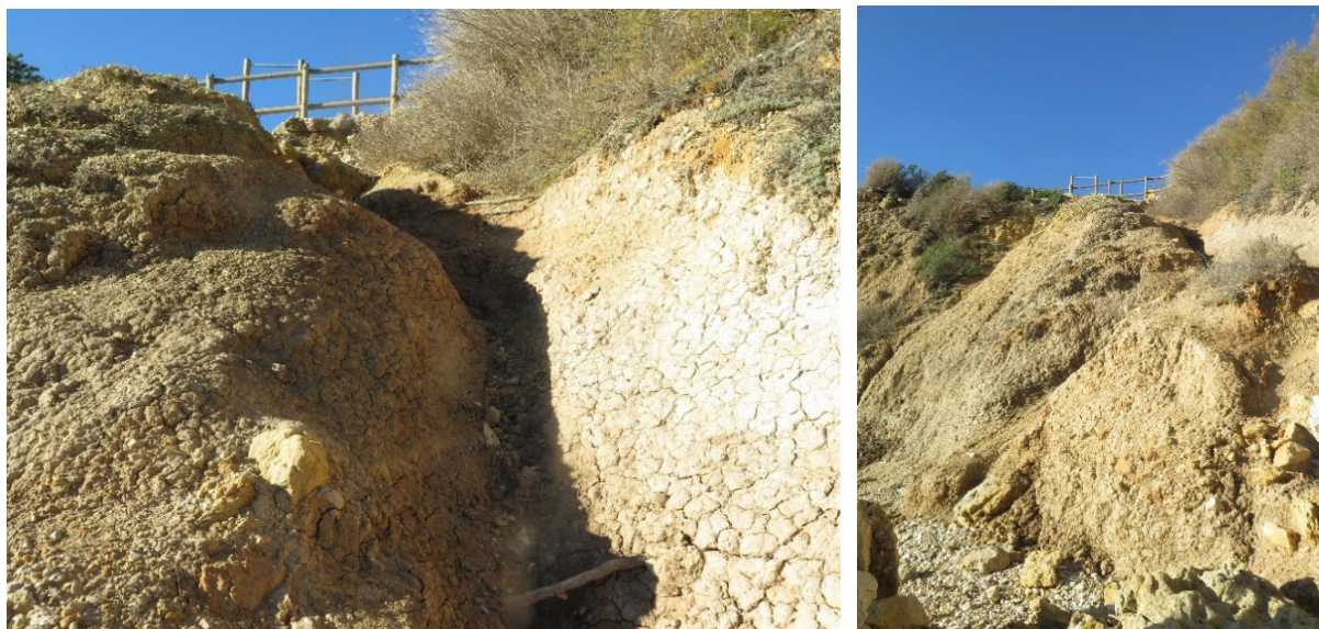
Figure 21 : Traces de ravinement en contrebas du sentier au niveau de la Pointe des Moulins © BRGM
