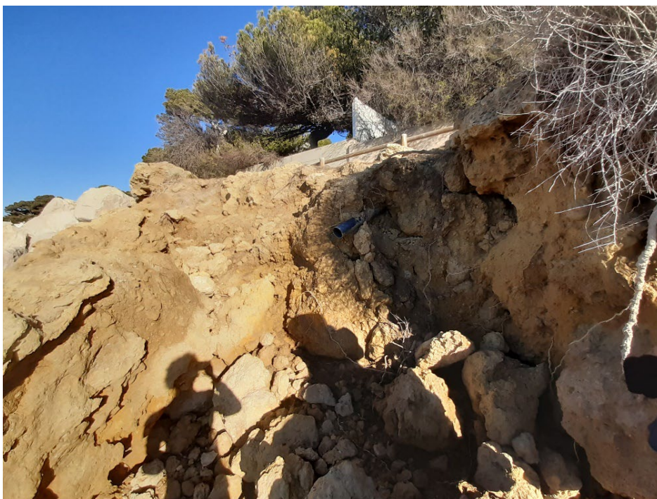
Figure 26 : Exemples d'aggravation de l'érosion par arrivées d'eau non maîtrisées en contrebas du sentier du Léopard © BRGM
