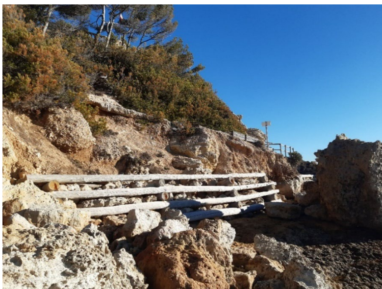
Figure 20 : Etat du gabion bois en 2024 © BRGM
